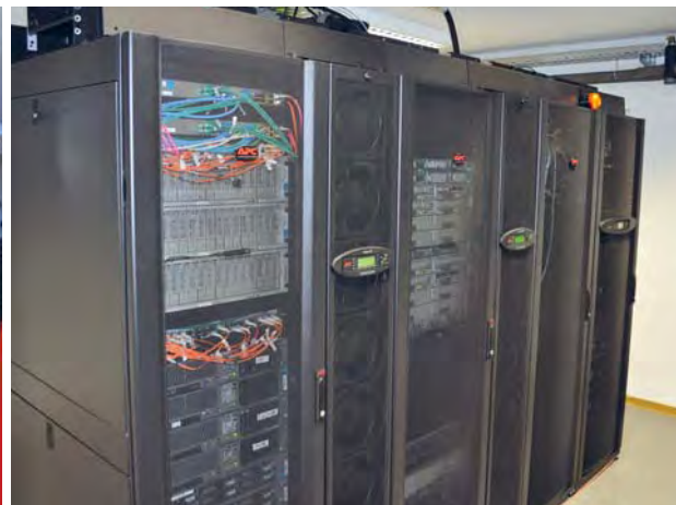
Serverschränke mit Reihen Kühlgeräten in Anklam
