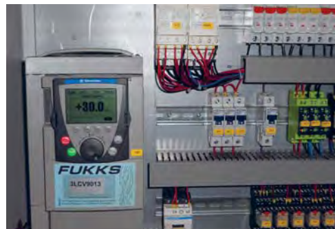
Schaltkasten mit Verbundanlage
