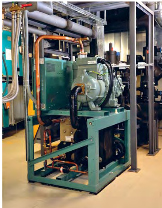
Maschinenraum für die Klimatisierung des Restaurants Erzabtei Pannonhalma, Ungarn
