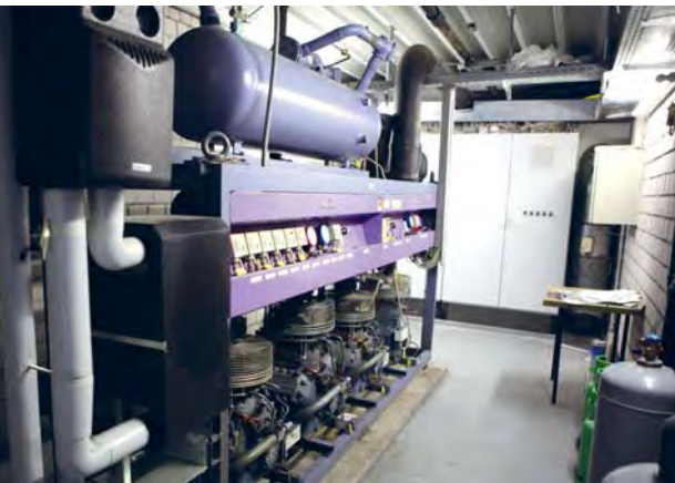
Maschinenraum der Kälteanlage in Plüderhausen
