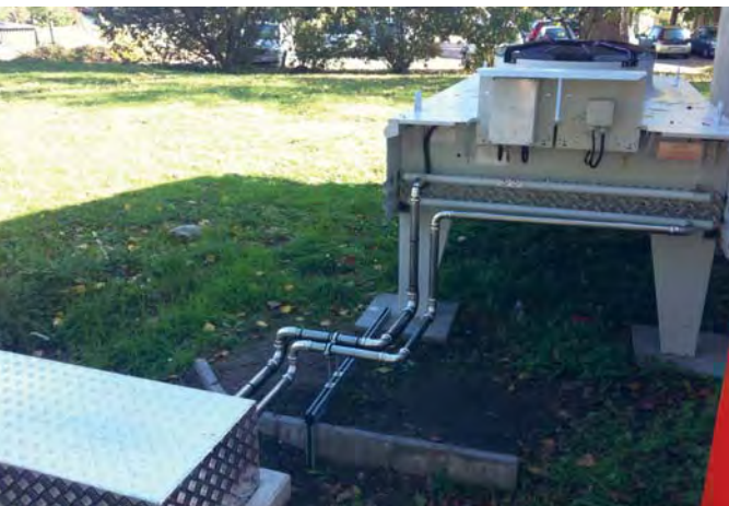
Ein FreeCooler wird in den kühlen Jahreszeiten betrieben
