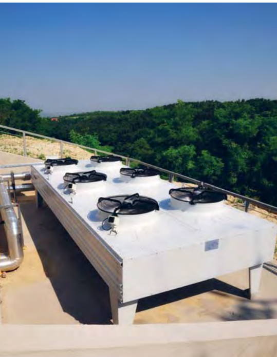
Verflüssiger für die Klimatisierung des Restaurants Erzabtei Pannonhalma, Ungarn
