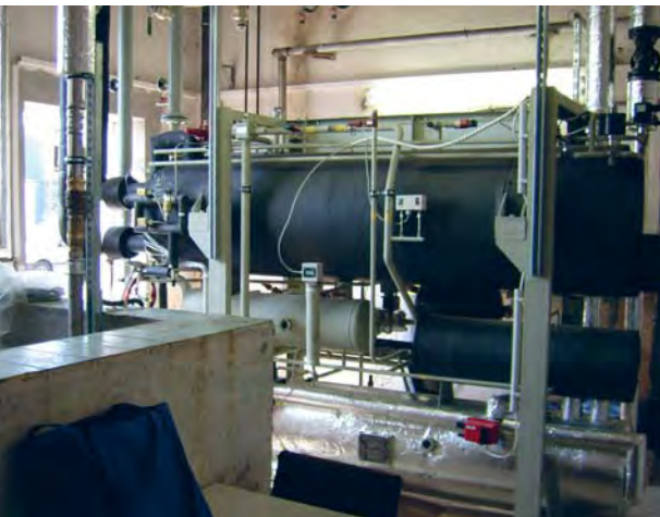
Anlage mit Eiswasserumlaufbecken
