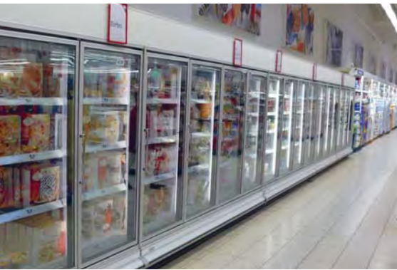
Kühlregal in einem Supermarkt
