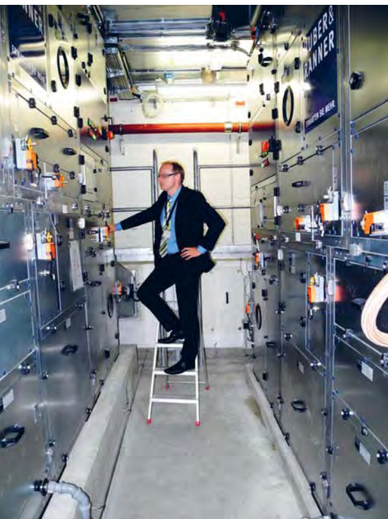
Klimakompaktgerät in Rechenzentrum des Bayerischen Staates in München
