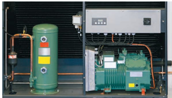
Druckluftanlage, Quelle: Fotolia © markobe
