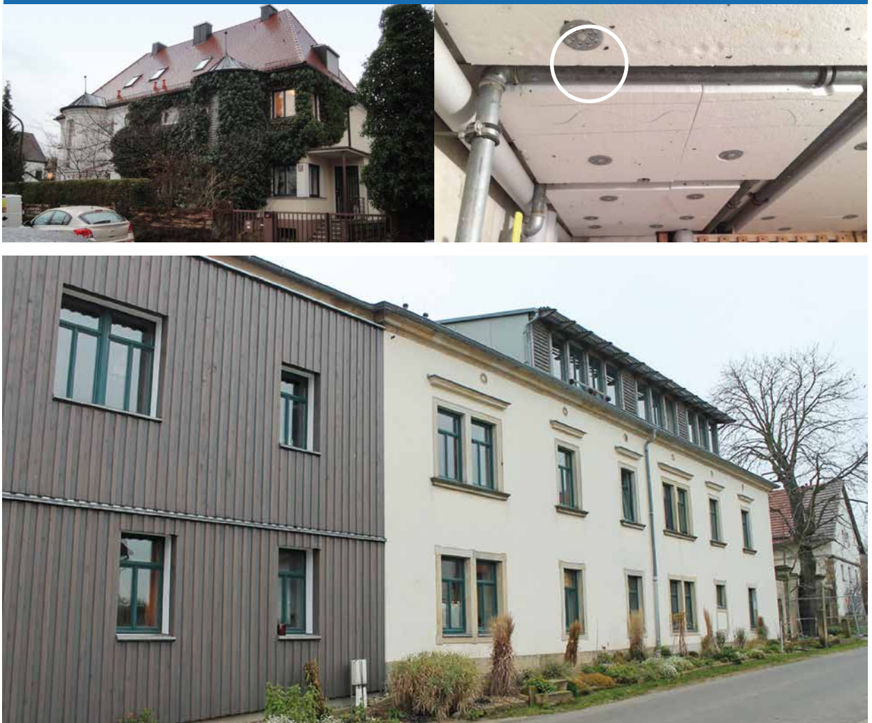
Abb. 18 Sanierungstest: Dachdämmung am Gebäude mit Baujahr 1936 (o. l.), Probleme bei der Dämmung der Kellerdecke (o. r.), Gebäude mit teilweiser Fassadendämmung (u.)
