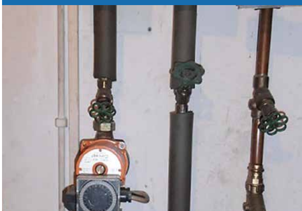
Abb. 20 Sanierungstest: Fehlende Dämmung von Armaturen
