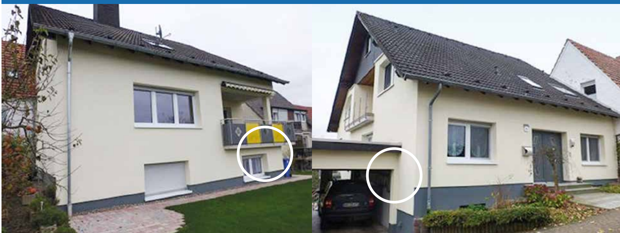
Abb. 17 Sanierungstest: Wärmebrücke am Balkon und beim Gebäudeanschluss
