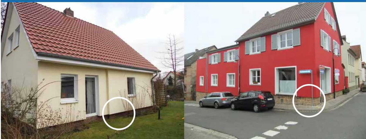
Abb. 16 Sanierungstest: Wärmebrücke an Fassade und Sockel
